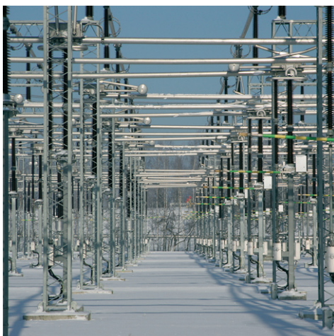
2.13 pav. 330 kV skirstykla žiemą
