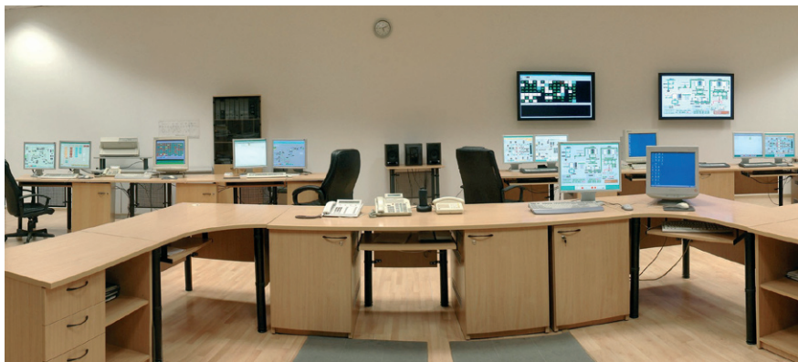
3.5 pav. Lietuvos elektrinės blokų valdymo pultas
