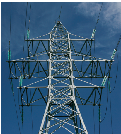
2.11 pav. 110 kV elektros linijos inkarinės atramos fragmentas
