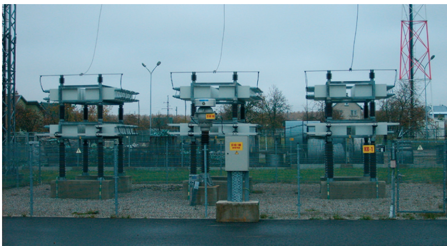
4.4 pav. Kondensatorių baterijos
