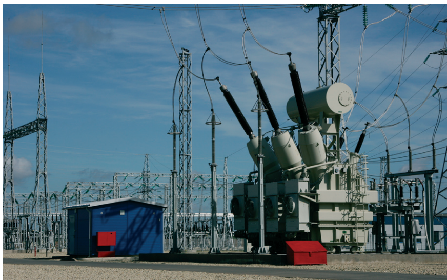
4.3 pav. 330/110 kV autotransformatorius
