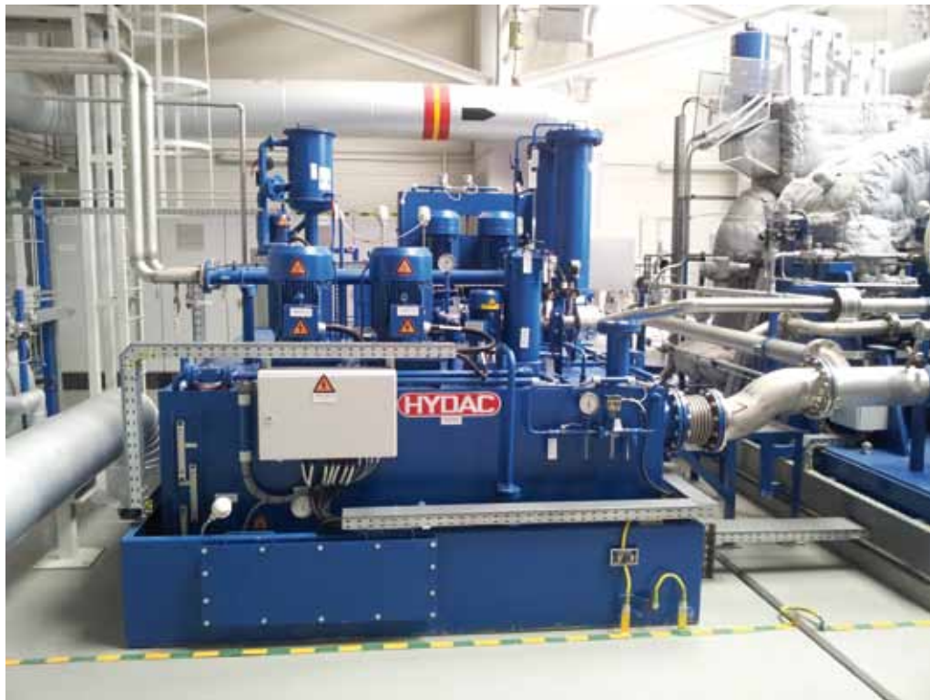
Šiaulių TE turbina ir generatorius
