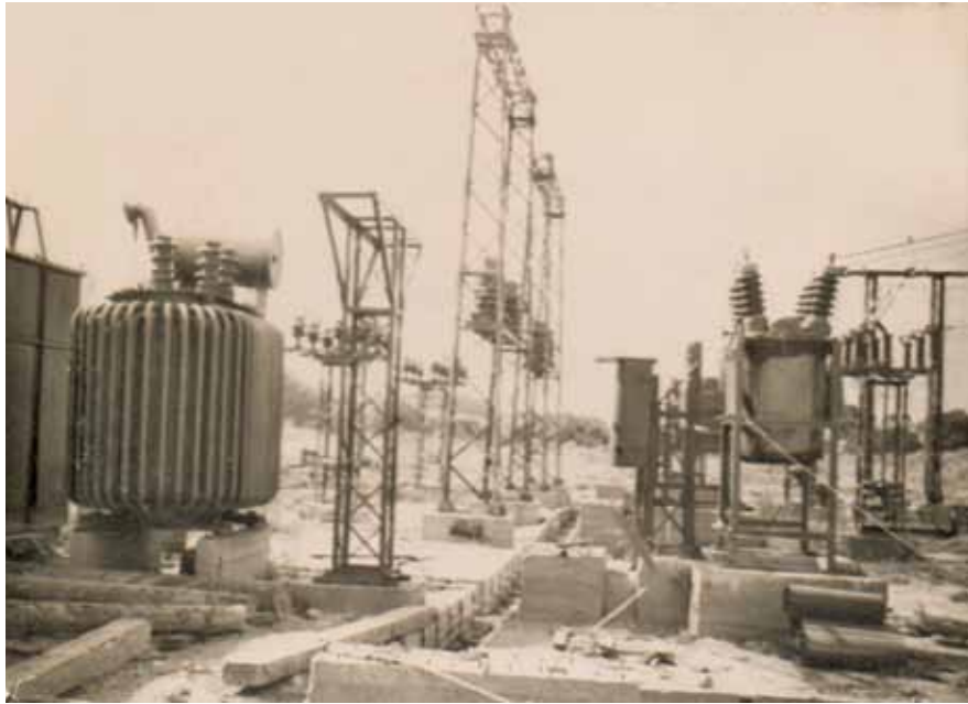
35/10 kV transformatorius ir 35 kV jungtuvas, 1959 m. birželio mėn.
