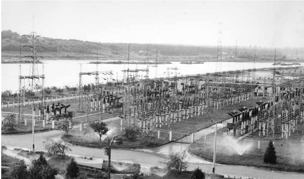
Kauno HE 110 kV atvira skirstykla užbaigus hidroelektrinės statybą
